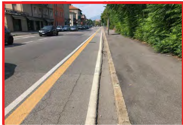
Dente di asfalto, via della Volta.
