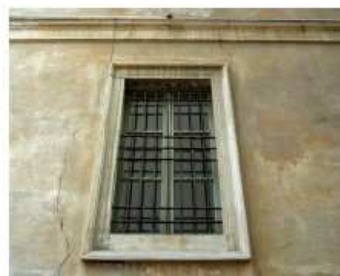
5. Prospetto sud, finestra del piano terra, contorni modanati in malta cementizia trattata ad imitazione del calcare bianco.
