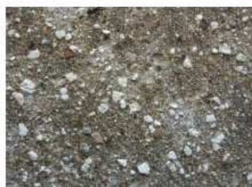
10. Intonaco di finitura eroso con presenza diffusa di calcinacci.
