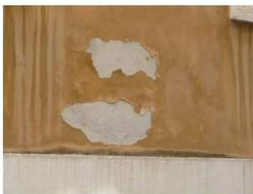
Foto 6 – percolamenti e distacchi di finitura – superfici intonacate
