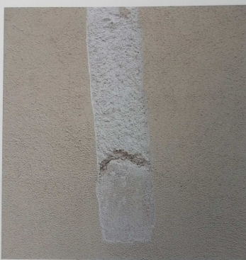
14. Limite tra gli intonaci del primo e del secondo piano.
