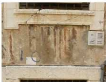
Fig. 12) Frattura del davanzale con caduta di frammenti di pietra.
