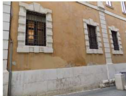
Foto 4 – parte bassa lato est – evidenze problematiche di umidità che interessano l'intonaco e scritte vandaliche
