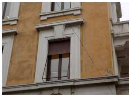
Foto 74 - Prospetto ovest - degrado delle superfici intonacate - alterazioni, macchie e lacune
