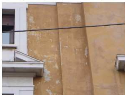
Foto 75 - Prospetto ovest - degrado delle superfici intonacate - alterazioni, macchie e lacune
