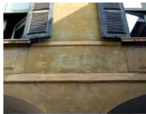
16. Corte interna, prospetto a sud, primo livello di coloritura tornato in luce per il dilavamento delle tinteggiature successive.
