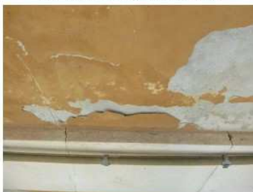
Foto 7 – distacchi di finitura – cavo telefonico sostenuto da corda in ferro arrugginita
