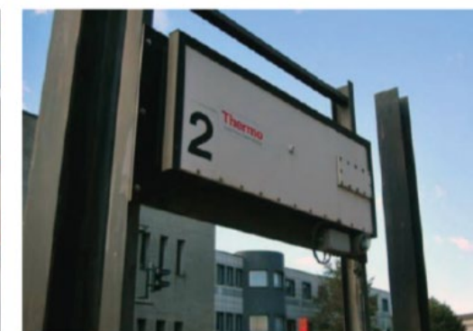
Rilevatori di radioattività all'ingresso dello stabilimento
