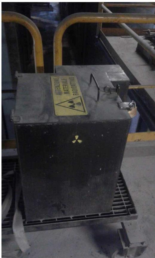
Foto 1 – Contenitore della sorgente radioattiva impiegata nella misura di livello del metallo nella paniera della colata continua.
